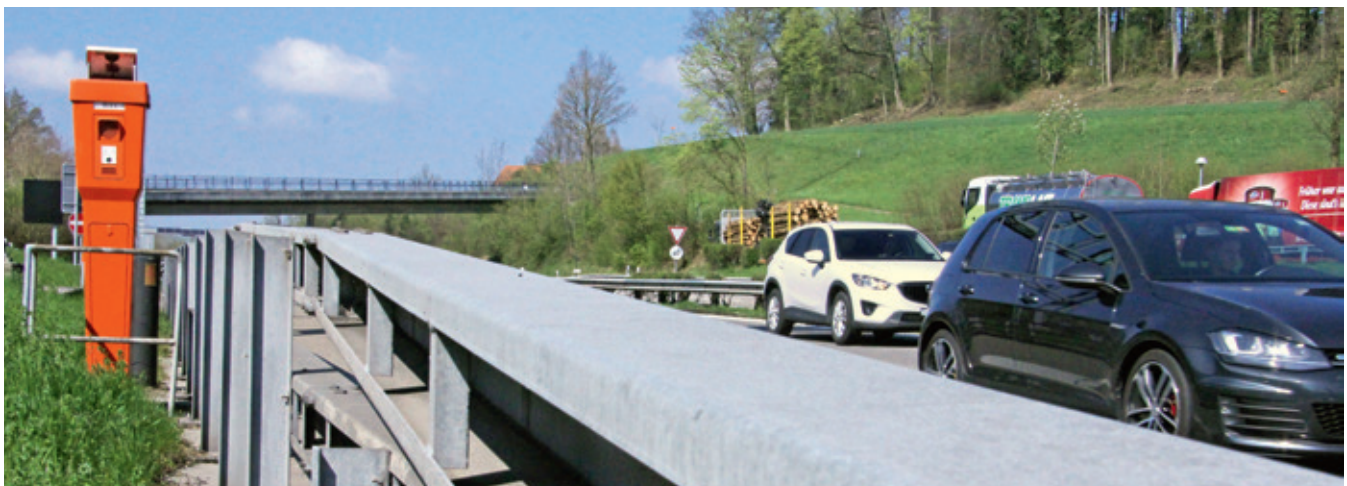
Die Fahrzeug-Rückhaltesysteme bzw. Leitplanken müssen den Anprall von schweren wie leichten Fahrzeugen auffangen und dämpfen können.
